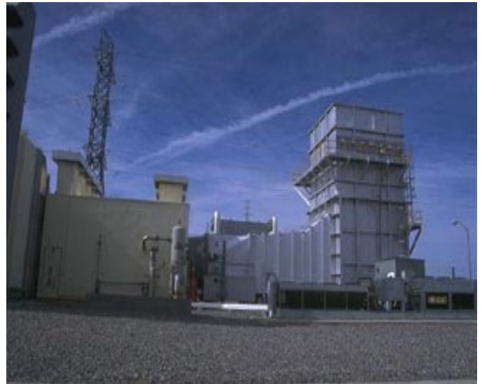
PLANTA GENERADORA DE ELECTRICIDAD DE TIPO TURBOGAS DE LA COMISION FEDERAL DE ELECTRICIDAD
